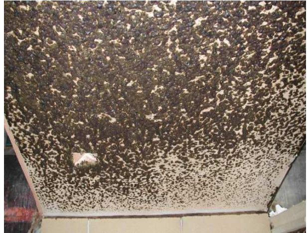
Bild 3 Betonoberfläche nach dem Brandversuch
